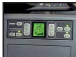
Climatisation à régulations de température
